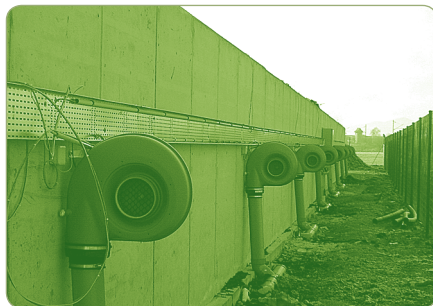
› Système d'aération pilotée.
