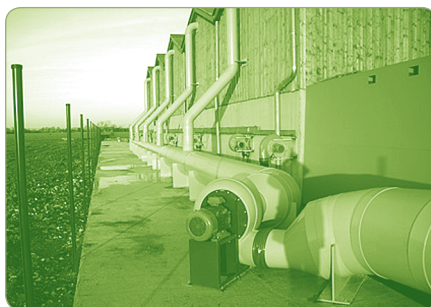
› Dispositif de canalisation et de traitement des gaz odorants
