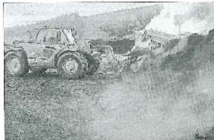
Les bords de canal de fermentation sont aérés et réglés régulièrement. Température : 70°.
